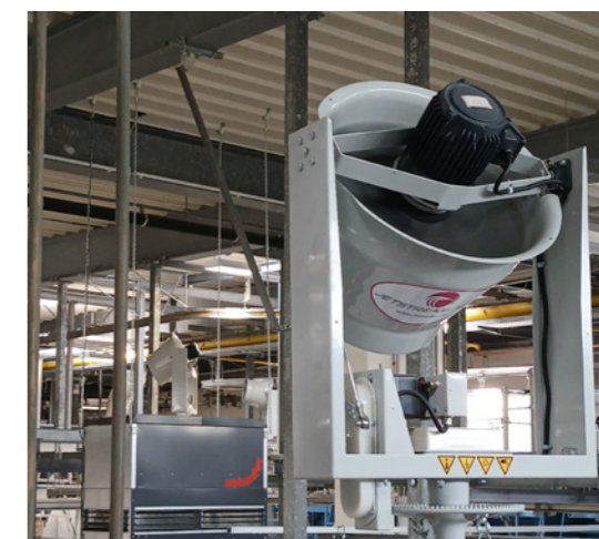
oben: Die Größe der neuen Luftreinigungsanlage von Zehnder ist beeindruckend: hier einer von 23 Jet-Stream-Aire-Ventilatoren.
